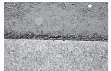
... kommt der Spalt oder Höhendifferenz zwischen Teerbelag und Marmorsteinen! Fotos: GZ.
