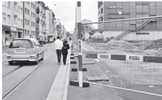
Am Gitter fehlt der Hinweis: «Bitte überqueren Sie...», dieses Schild und der Fussgängerstreifen befindet sich 15 Meter weiter «hinten». Foto: GZ.
