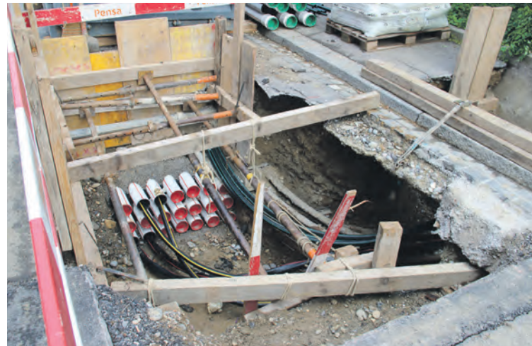
Baustelle an der Blauenstrasse: Hier werden Glasfaserkabel und neue Leitungen für den elektrischen Strom verlegt.
