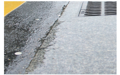
... 3: im Winter öffnet sich - in der «Vesolpur» - der heimtückische Spalt zwischen Teerbelag und Marmorplatten noch mehr... ! Das Geflicke am «Boulevard» geht weiter... Fotos: GZ.
