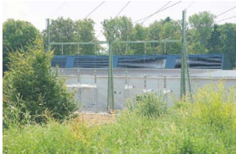
Das Unterwerk Froloo oberhalb von Therwil.
