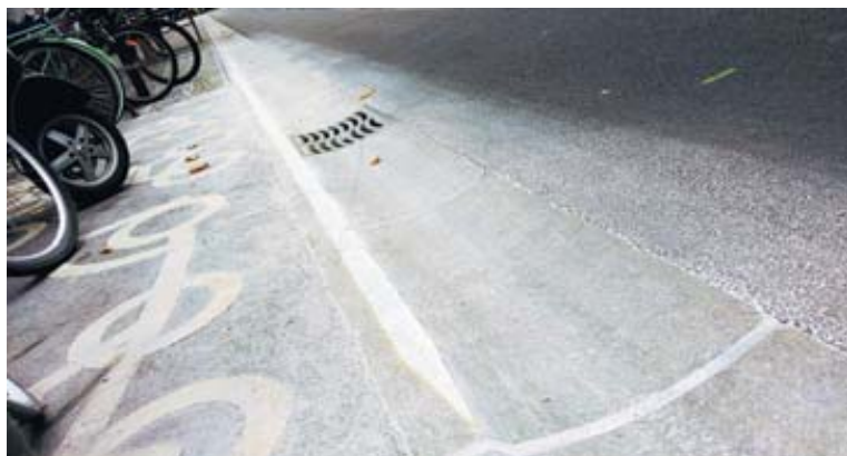
Die Kanten des teuren Marmors werden zurzeit abgeschliffen auf dem «Boulevard-Gepfusche»-Konstrukt Güterstrasse. Das unsägliche Geknorze geht weiter... Foto: Martin Graf
