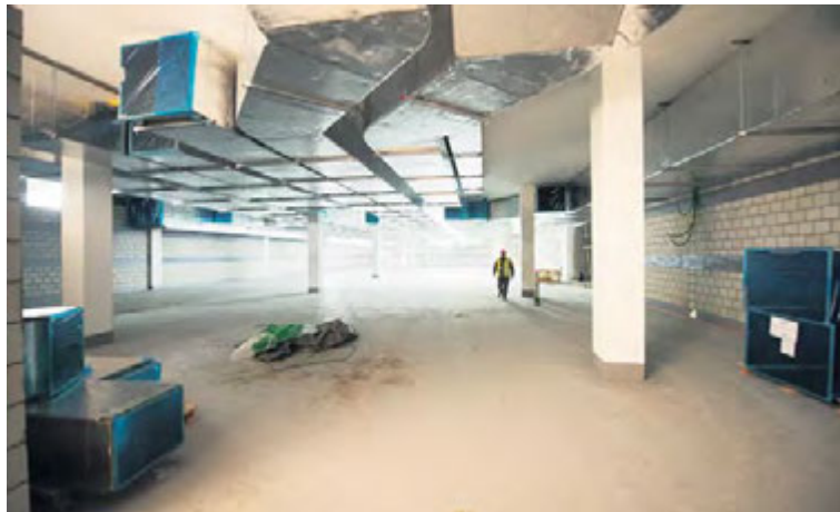
Lüftungskanäle ohne Ende.
