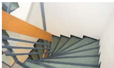
Dieses Treppenhaus ist laut Brandschutzvorschriften zu schmal.
