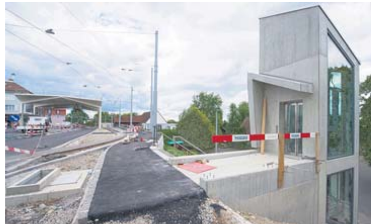
Vor der Tramhaltestelle beim neugebauten Zoll, mit Tramschleife und Abzweigung nach St. Louis, gibt es eine Treppe und einen behindertengerechten Lift für Anwohner und die Menschen aus dem REHAB.
