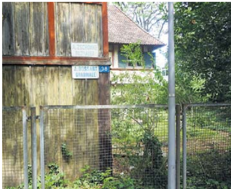
Das Wettsteinhäuschen, Claragaben 38, samt Garten, zeigt sich im Juli 2017 in desolatem Zustand. Am Atelierbau hängen immer noch die beiden Namensschilder der letzten Mieter Zschokke und Bossert.
