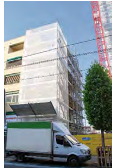
Dieser Anbau an der Güterstrasse dient primär der Luftzufuhr für das grosse MOH.
