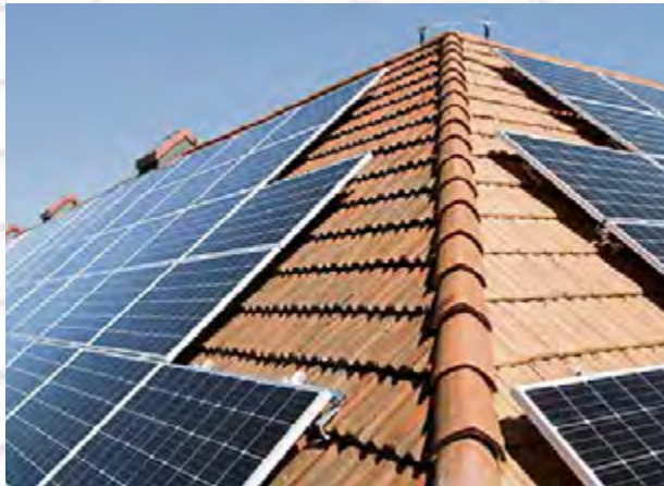
Schweizweit befindet sich die grösste «Power-to-Heat»-Photovoltaikanlage im Wohnbereich im Gundeli. Foto: zVg
