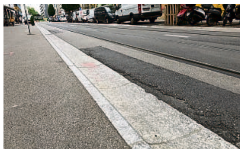
Die meist defekten Granitrinnen sollen bald verschwinden in der «Boulevard» Güterstrasse.
