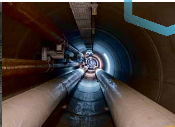
Blick in den Energieleitungstunnel unter den Schienen der SBB. Grosse Wasserleitungen und neue Fernwärmeleitungen bringen Wärme und Trinkwasser ins Gundeli.
