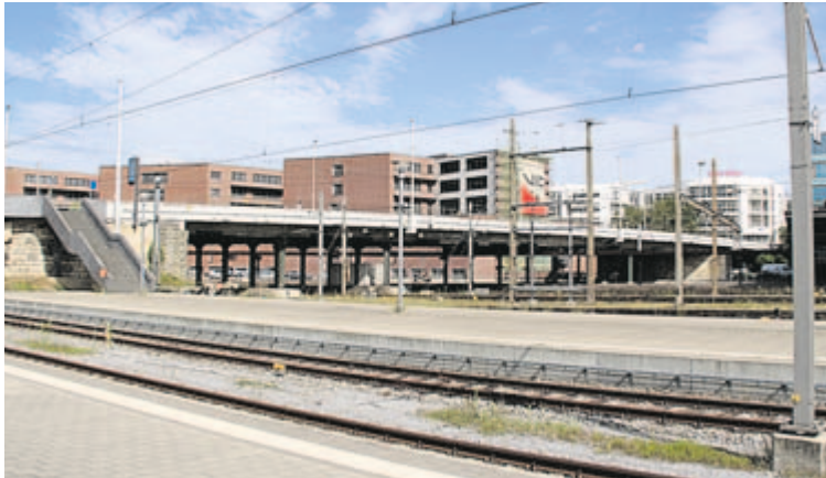
Die Margarethenbrücke muss zusätzlich gestützt werden, da die Gerbergelecke (unten links) überlastet sind. Allgemein macht diese alte Brücke von 1930 keinen vertrauensvollen Eindruck.
